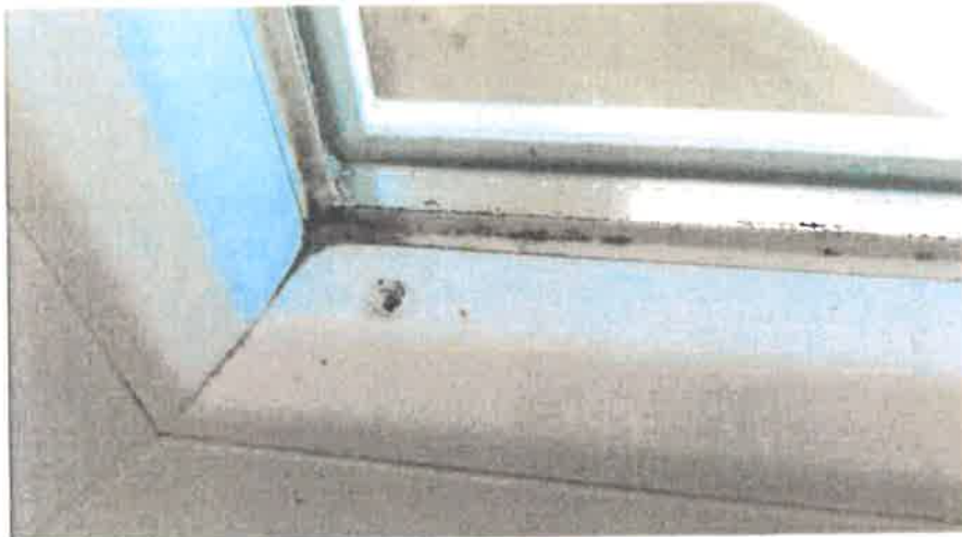
Fotografia č. 19 – Plastové okná, ktoré projektová dokumentácia uvažuje ponechať sú izolačným dvojsklom a hliníkovým dištančným rámikom, s nefunkčnou žalúziou a poškodeným profilom okna.
