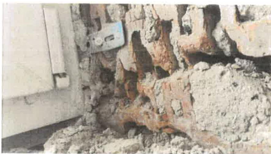
Fotografia č. 23 – Pôvodné okná sú kotvené do nepripraveného ostenia.
