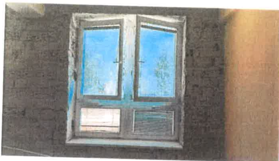
Fotografia č. 25 – Popri preukázateľne nesprávnom zabudovaní, sú pôvodné okná znehodnotené aj zatečením do medzisklenného priestoru, čo je možné odstrániť iba výmenou izolačného zasklenia.
