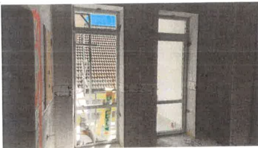
Fotografia č. 20 – Pohľad na plastové balkónové dvere a pevné presklenie na 2.NP s izolačným dvojsklom s triedou lomu A, čo je pre ľahkodostupné otvorové konštrukcie v rozpore s normou.
