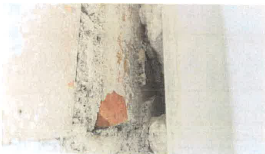
Fotografia č. 24 – V pripojovacej škáre je pri pôvodných oknách nesúvislá tepelnizolačná vrstva, čo vytvára tepelné mosty.
