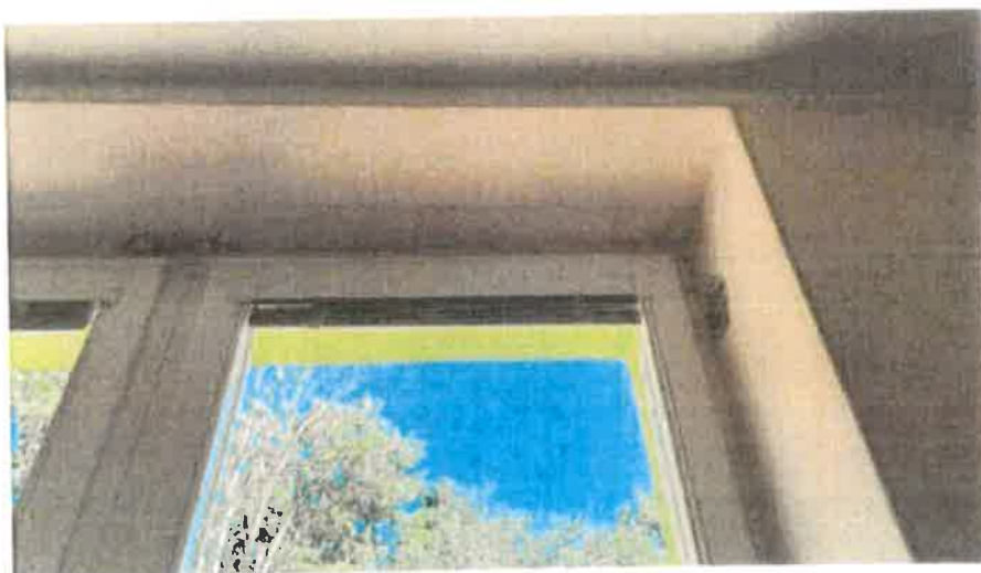
Fotografia č. 15 – Pohľad na otvory v ostení, revízna demontáž, preukázanie nesprávnej montáže.
