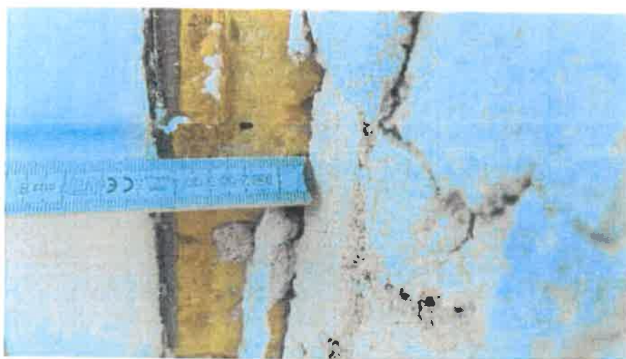
Fotografia č. 32 – Nedovolene široká pripojovacia škára. Nutný je zásah do konštrukcie okna, alebo do stavebnej konštrukcie ostenia.
