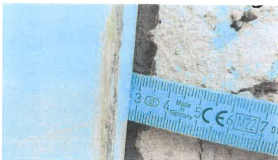
Fotografia č. 33 – Okolo pôvodných okien vznikajú tepelné mosty z dôvodu nesprávnych pripojovacích detailov. Rozpor S STN 74 6200.
