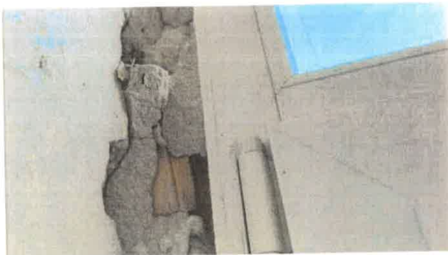
Fotografia č. 29 – V pripojovacej škáre medzi pôvodnými oknami a ostením sú ponechané drevené podložky a vzduchové medzery, nesprávna montáž.
