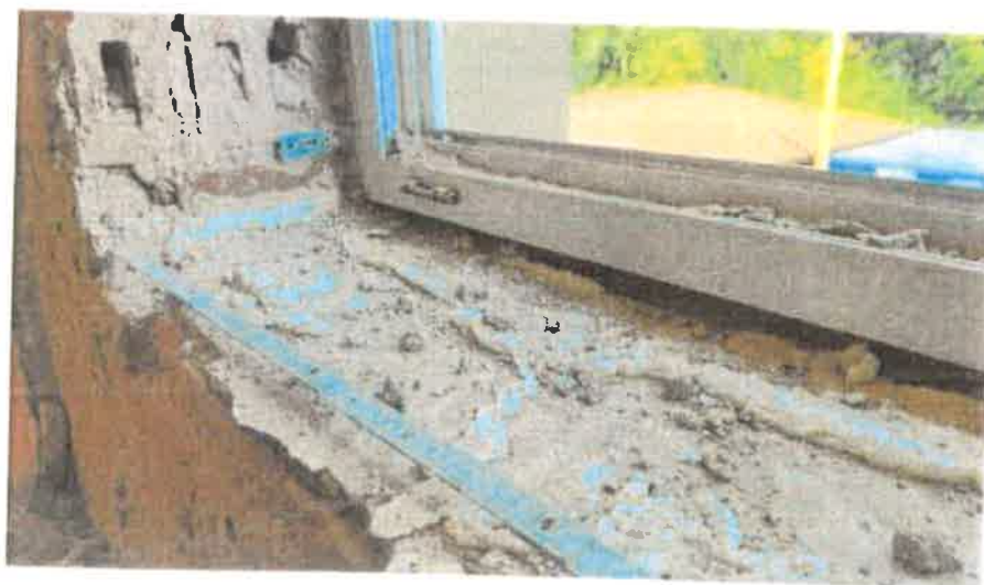
Fotografia č. 27 – pôvodné okná sú bez bezpečného kotvenia. Vzdialenosť kotiev je na viacerých miestach 180mm, čo je v rozpore s normou, okno je nebezpečné.
