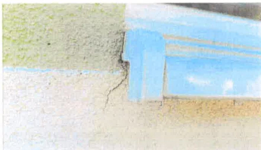
Fotografia č. 9 - Zo strany exteriéru netesné miesta v styku kontaktného zateplovacieho systému, praskliny.
