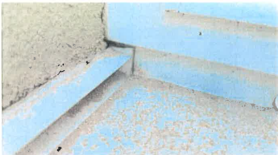
Fotografia č. 7 – Zo strany exteriéru netesné miesta v styku okno – exteriérový parapet – krytka exteriérového parapetu. Miesto zatekania vody z účinkov hnaného dažďa.
