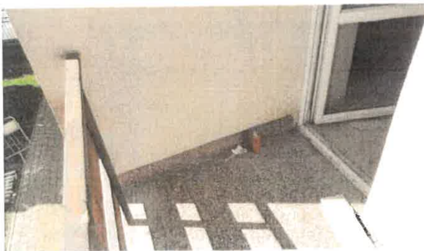
Fotografia č. 21 - Pohľad na plastové balkónové dvere na 2.NP zo strany exteriéru, izolačné dvojsklo je nie bezpečné, nie je zabudované izolačné sklo s triedou lomu skla B, alebo C.
