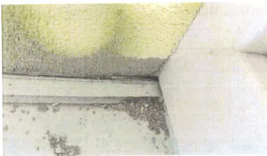
Fotografia č. 18 – Nesprávny detail medzi plastovým oknom – krytkou exteriérového parapetu – a exteriérovým ostením, zatekanie.
