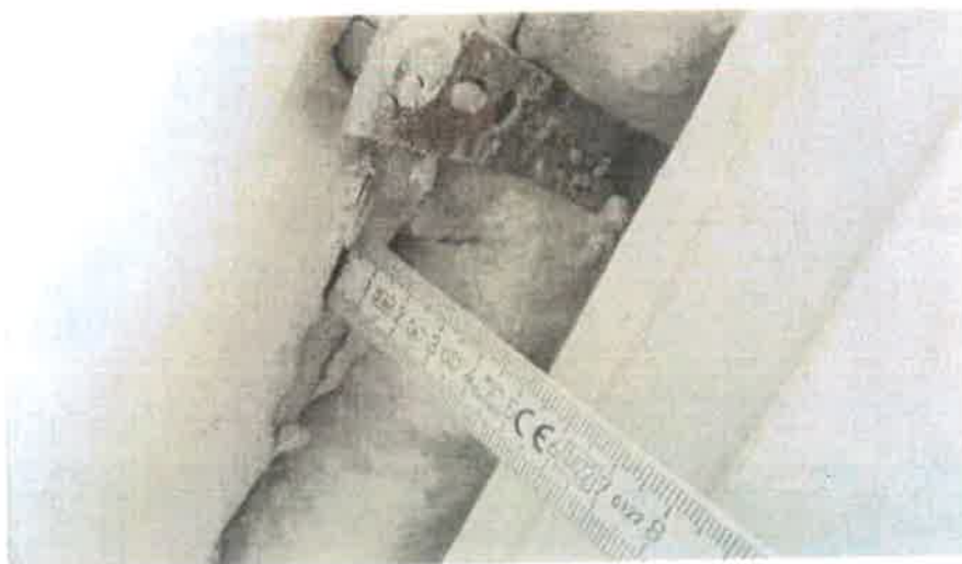
Fotografia č. 30 – Pri pôvodných oknách dosahuje pripojovacia škára 50mm, kotvy sú hrdzavé, oslabené, nefunkčné kotvenie okna.
