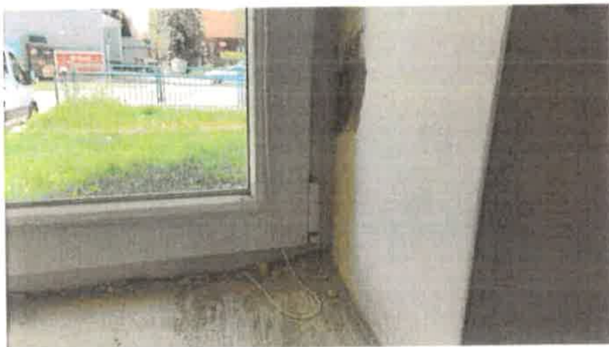
Fotografia č. 17 – Revízia demonťáž a potvrdenie nesprávnej montáže okien.
