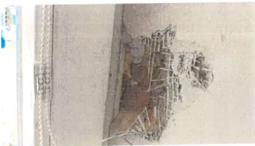
Fotografia č. 14 – Po revíznej demontáži sa preukázalo, že v styku rám – ostenie nie je aplikovaná paronepriepustná a vzduchotesná vrstva na interiérovej strane pripojovacej škáry.
