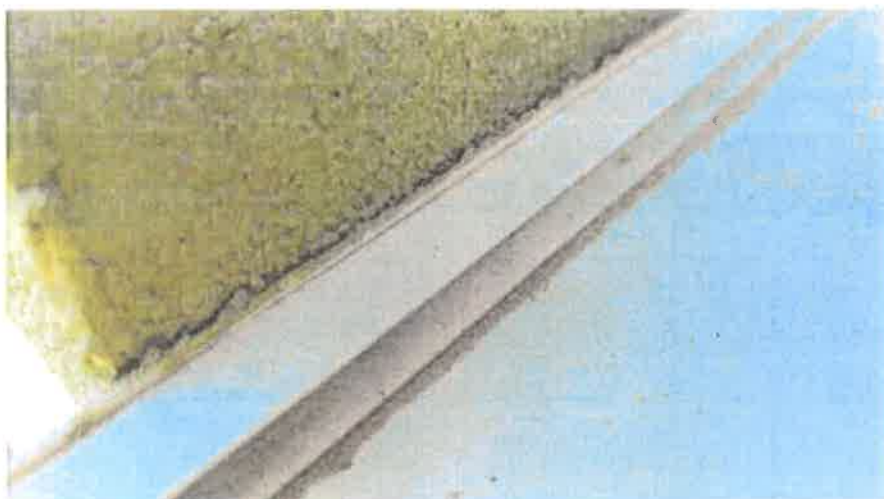
Fotografia č. 8 - Zo strany exteriéru netesné miesta v styku krytka exteriérového parapetu – exteriérová povrchová úprava.
