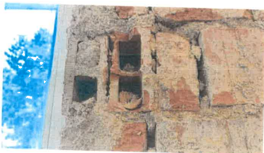
Fotografia č. 26 – Ostenia, ako súčasť teplotného poľa, sú na mnohých miestach z pálenej tehly s otvormi v smere interiér – exteriér, čo zapríčiňuje zníženie povrchových teplôt na strane interiéru.
